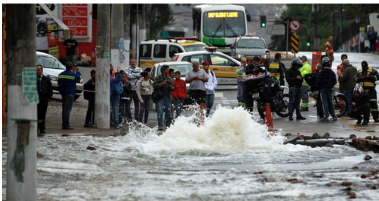
FIGURA 6 - Estouro de adutora na zona norte da capital paulista, em Outubro de 2014, uma das costumeiras imagens representativas da falta de manutenção da rede pública de abastecimento de água, que podem ser estendidas para as demais metrópoles brasileiras (Fonte: < http://infraroi.com.br/robo-pode-detectar-desperdicio-de-agua-nas-redes-da-sabesp-e-de-outras-concessionarias/ >. Acesso: 6-12-2017).
